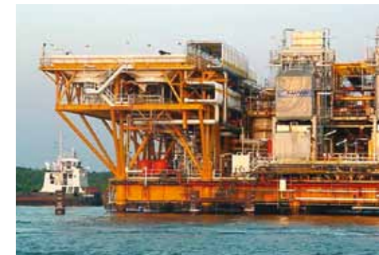
Air Fin Coolers Tunu, Indonesia
